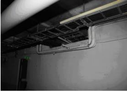
Genomföringen till el-rummet som leder direkt ut i garaget
