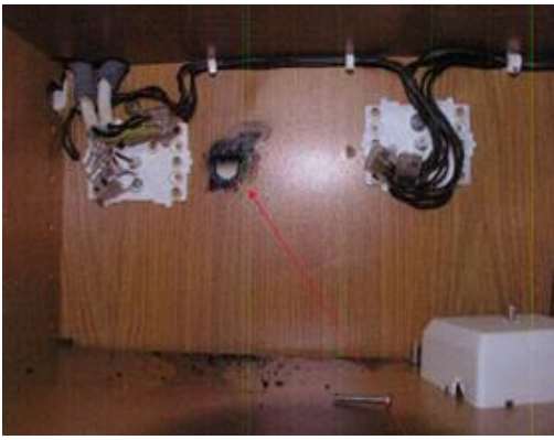
Närbild var transformatorn satt. Det har brunnit hål i träskivan
