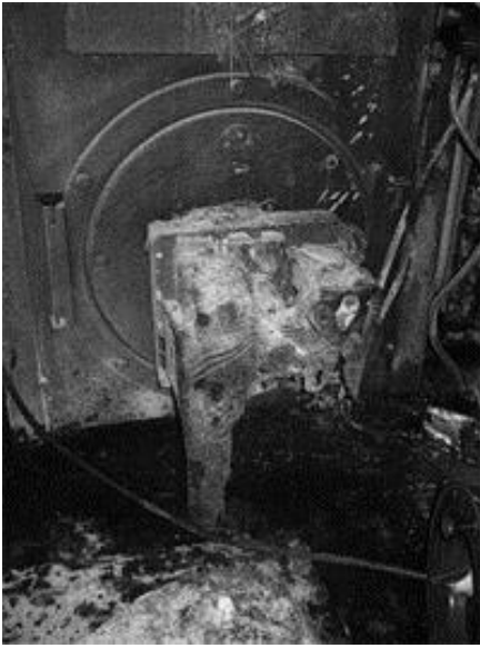
Ovansidan på brännaren med en trolig sekundär pölbrand av smält plast på golvet.
