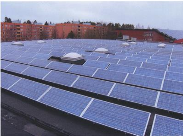
Brand i större solcellsanläggning.
