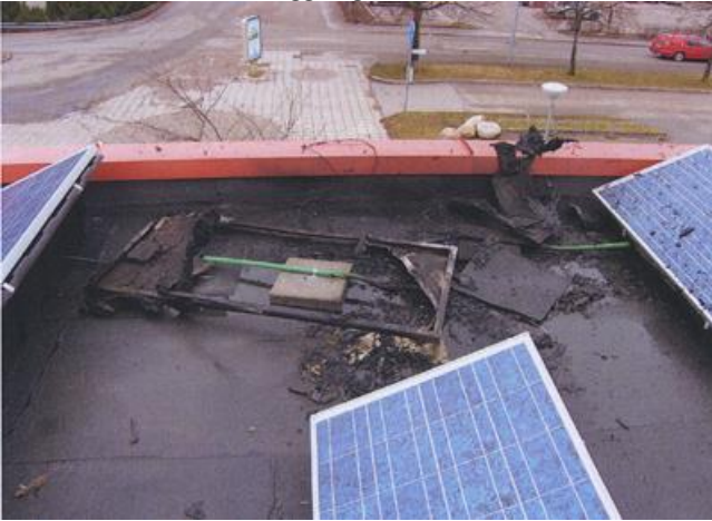
Bilden visar den brandskadade solcellen.
