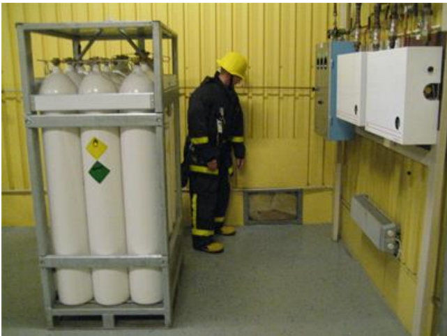
Händelsen inträffade farligt nära sjukhusets gascentral med syrgas.
