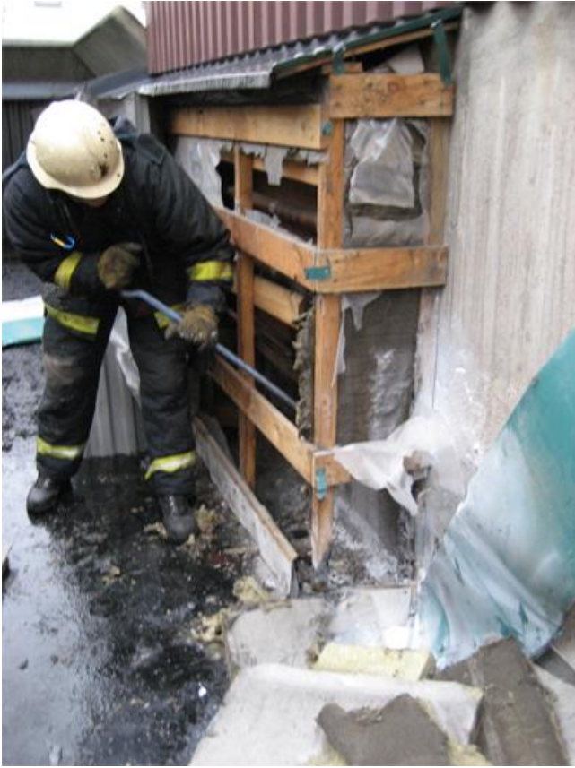
Hetarbete tände asfalt som antände isolering i källaren.
