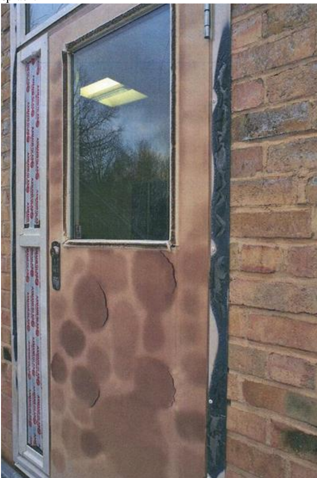
Dörren som är på andra våningen, har skador. Dörrblad och foder.
