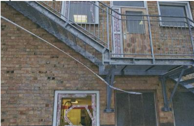
Fasaden på skolbyggnaden var kraftigt påverkad, då tiotal fönster sprack.
