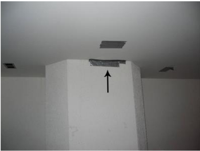
Bilden visar schaktet upp mot innertaket i vardagsrummet. Där silvertejp syns har vi en genombränning. (pil).
