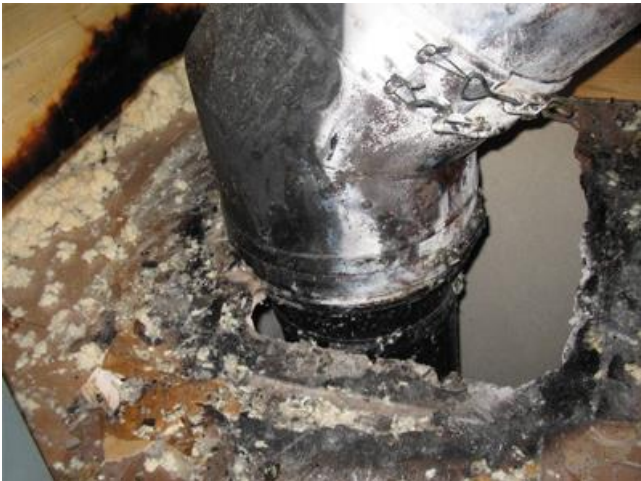
Bilden visar de två olika rökrörs dimensionerna. Till vänster syns det att innertaket har varit väldigt nära det isolerade rör på 30 (sotarens anm.) Och som är den orsak som vi kommit fram till.
