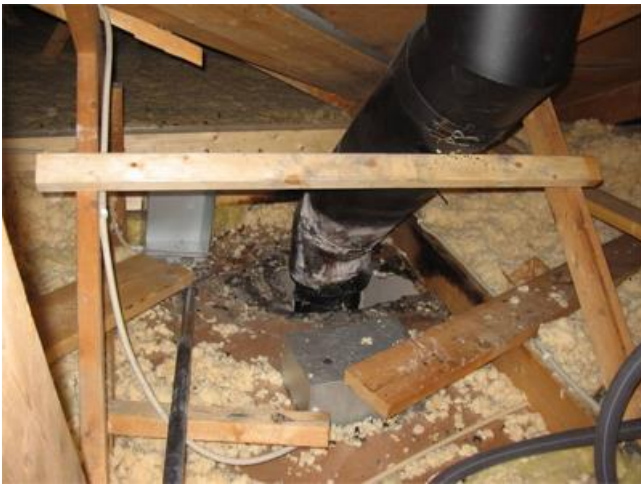
Bild på rökrör som kommer upp på vinden och är i vinkel. Vinden är isolerad med lös ull som är insprutad. Skarven mellan olika rör syns i samband med övergång från undervåning och tak.
