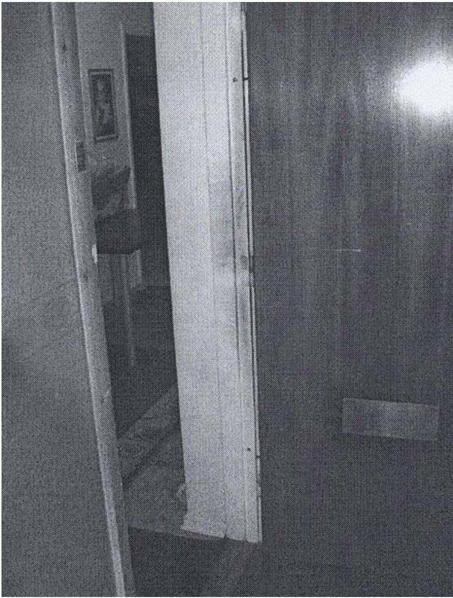
Rökinträngning via otäta lägenhetsdörrar.
