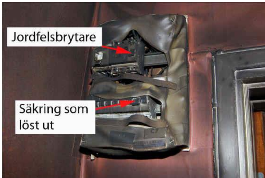
Bild 1. Bilden visar el-centralen. På bilden syns att en säkring och jordfelsbrytaren löst ut.
