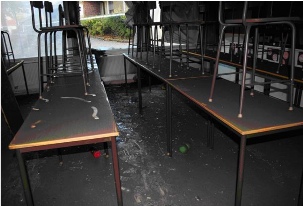
Bild 2. Kraftiga rök- och sotskador i hela kemilektionssalen.
