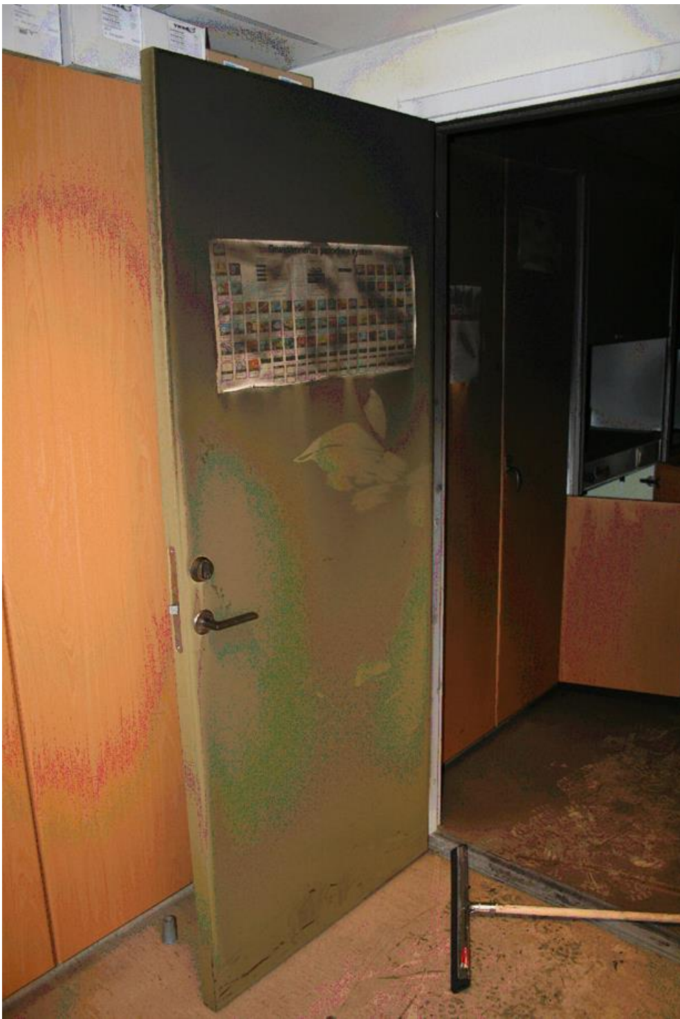
Bild 1. Dörren in till brandrummet från intilliggande arbetsrum.
