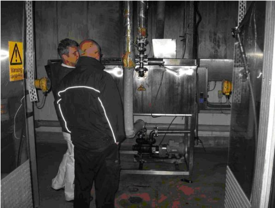
Frityroljerenare sedd från dörröppning.
