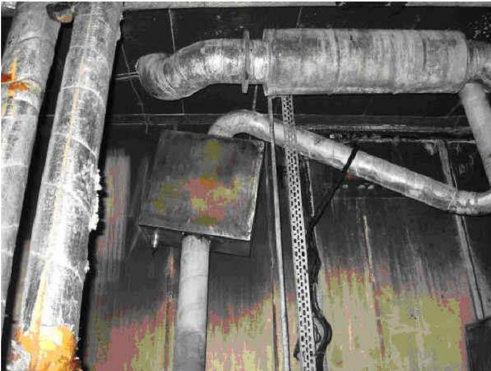
Skador i tak och på ventilationsutrustning.
