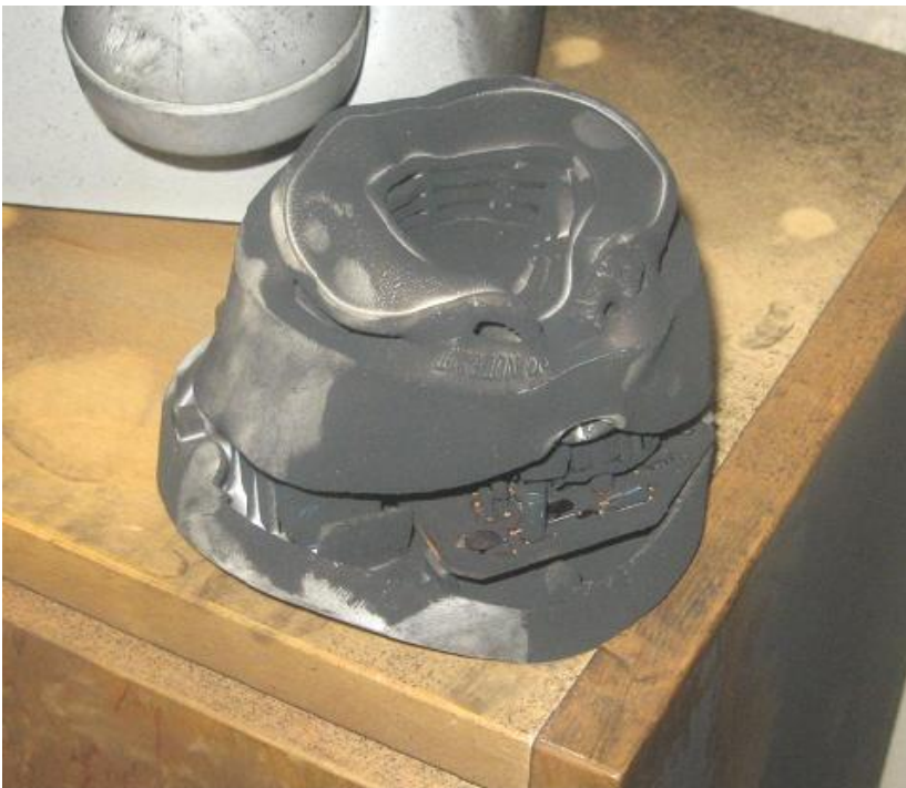
Brandvarnaren som var monterad i halltaket, smälte av värmen.
