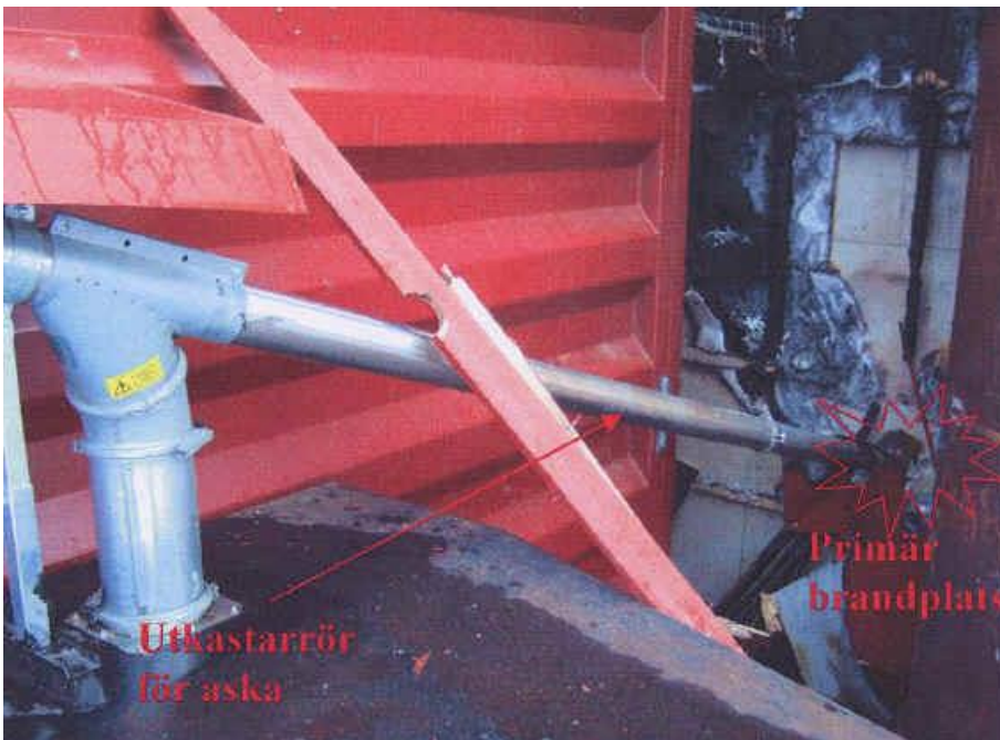
Bild 2 visar samma askrör där den är belägen utanför väggen och transporterar askan vidare till asklådan.
