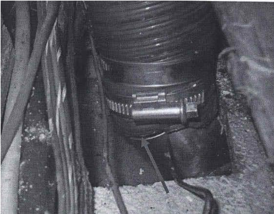
Bild 5. Bilden visar var slangen lossnat i påfyllningsröret till bränsletanken. Pilen visar var bensinen läckt ut.
