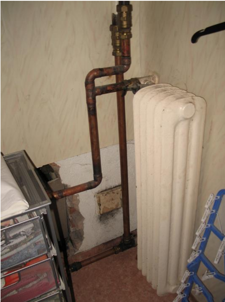
I angränsande rum finns sotluckan och värme rören till övriga elementen
