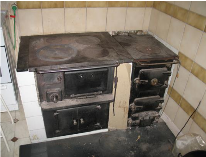
Vedpannan till höger orsakade skorstensbranden
