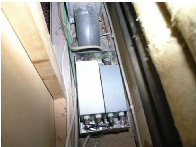
Omformaren som var placerad inuti fönsterbänken.
