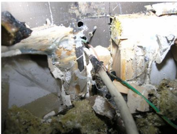
Genomföringen genom fönsterkarmen. Den skadade kabeln har suttit i det övre hålet. På den undre kabeln ser man att det finns inget skydd för kabeln
