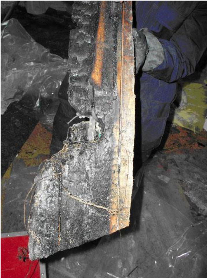
Bild tre visar brandskadorna på den träregel som den aktuella väggströmbrytaren varit fastsatt vid.
