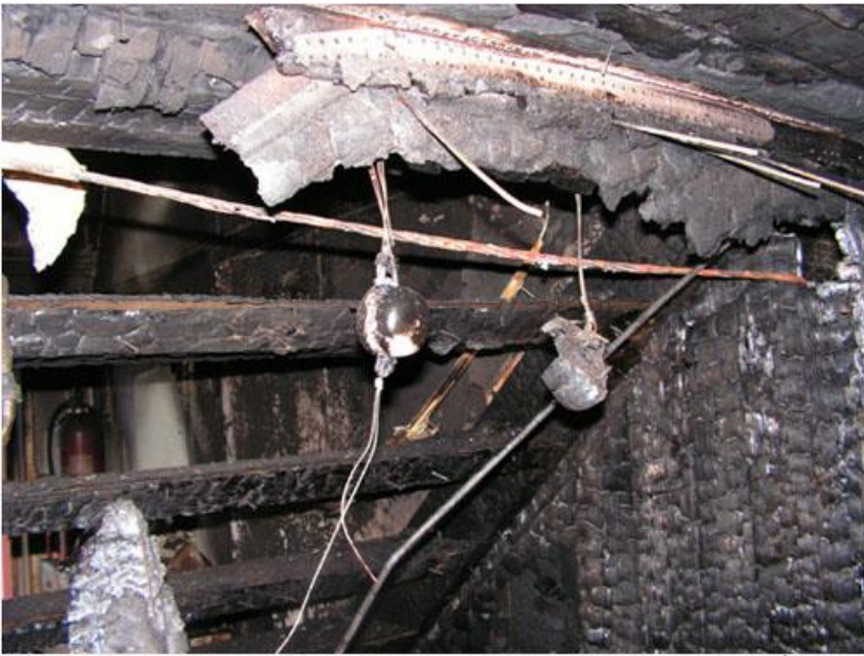
Bild 8. Kopplingsdosa och armatur till lampa. Kablage har överledningsskador. I och med placering på under trappan har rörelseskador kunna uppstå.
