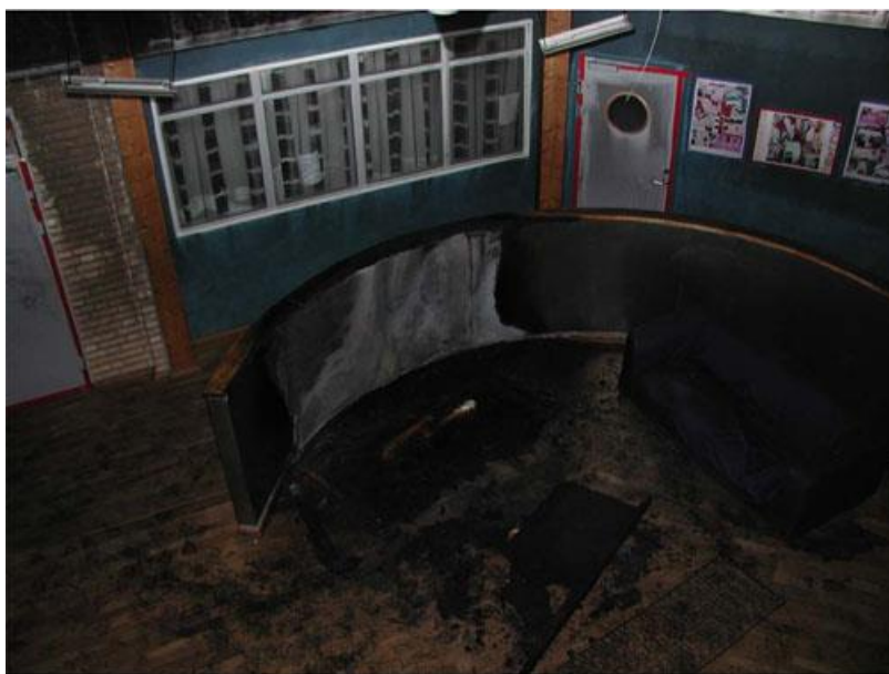
Den brand-och rökskadade biblioteket/samlingslokalen
