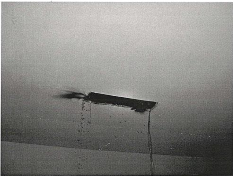
Bild 4. Hål i tak där lysrörsarmaturen i bild 3 har suttit (bild tagen innan brandmännen frilade bjälklaget). Till vänster i hålet rinner släckvatten ned och till höger syns det avslitna kablaget.
