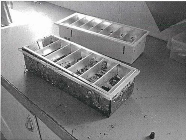
Bild 7. Lysrörsarmaturen och en oskadd armatur.
