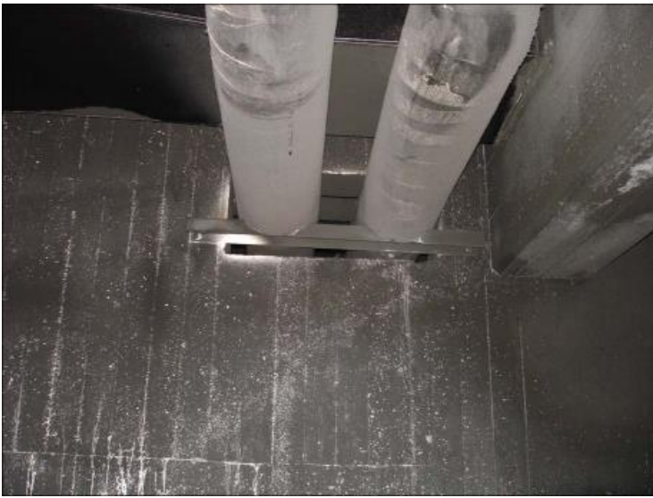
Ett av de två relativt stora hål i brandcellen mellan A- och B-delen.
