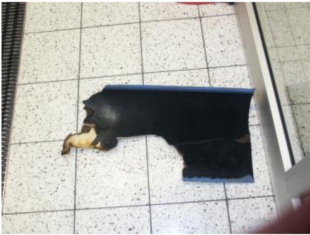
Delar av den brunna skumplastisoleringen.
