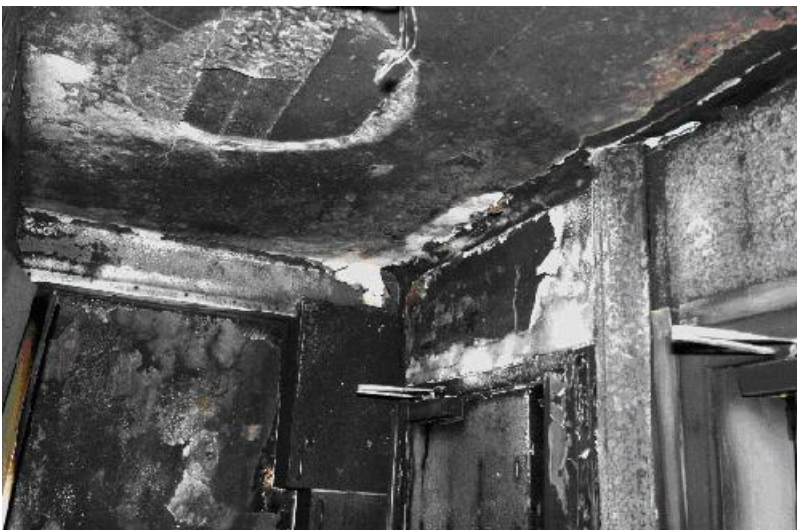
Putsen i taket har fallit ned.
