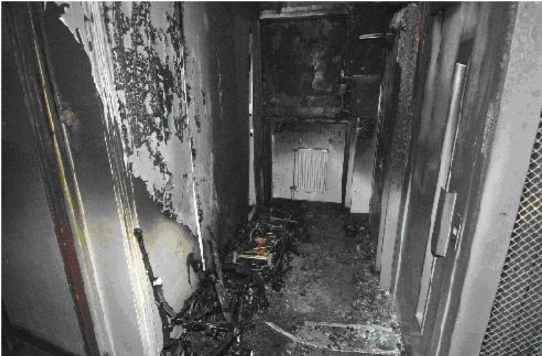
Barnvagnarna hade placerats i ett "blindutrymme" utanför utrymningsstråket.
