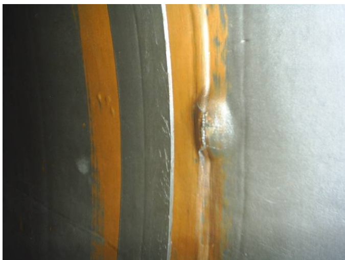
Bild 3.1 – Bild tagen inifrån vagnen på den spruckna gummeringen.
