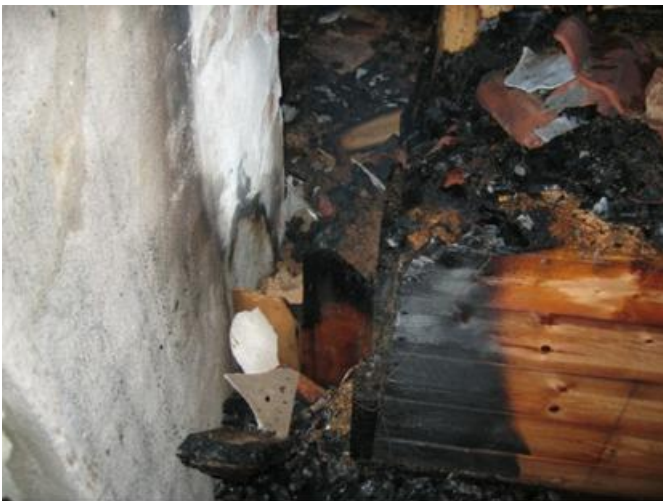
Brandskador vid golvbjälklaget i anslutning till murstocken. På bilden kan också ses att putsen på murstocken varit tunn då teglet skymtar fram på vissa ställen.
