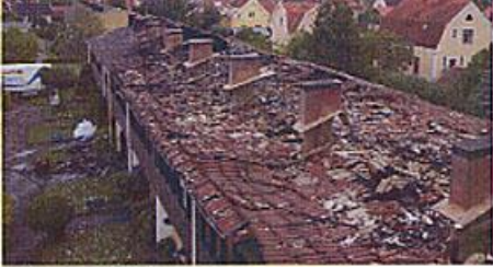
Efter branden. Längst bort mera kvar av taket. Branden har startat hitom bilden på höger sida av byggnaden
