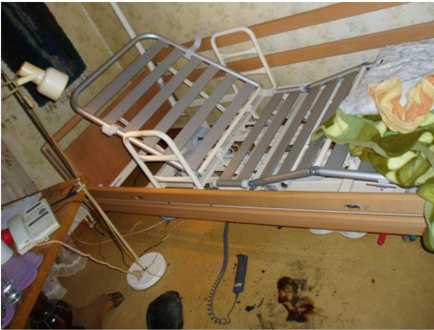
Brandskador på golv vid sidan om sängen
