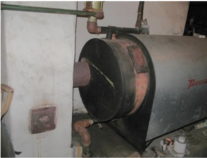
Konvektionsdelen var nästan igensatt av sot och slaggprodukter. Askluckan var röd av värme vid upptäckt
