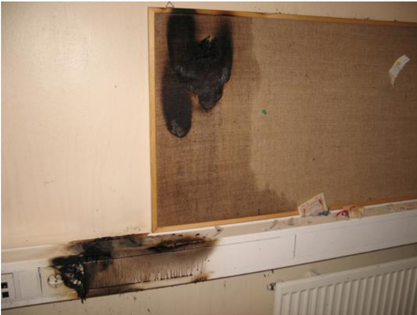
Brinnande gardinrester har ramlat ner och hamnat på elinstallations list, med små brandskador och värmeskador som följd. Anslagstavlan har lätta värmeskador
