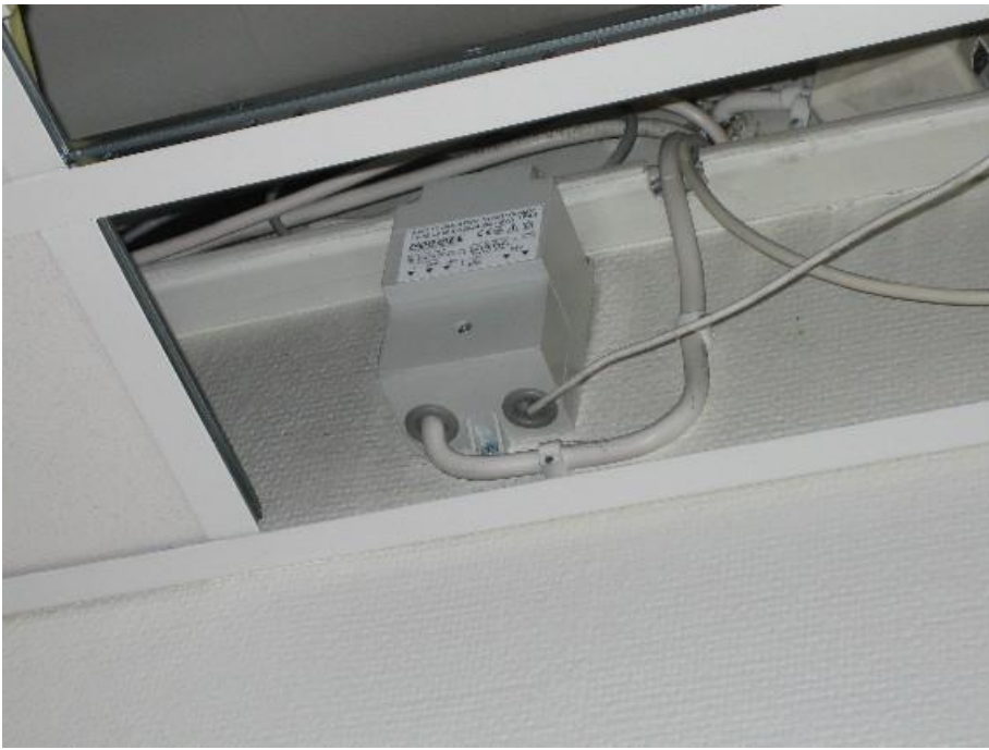
En likadan transformator på annat ställe i butiken.
