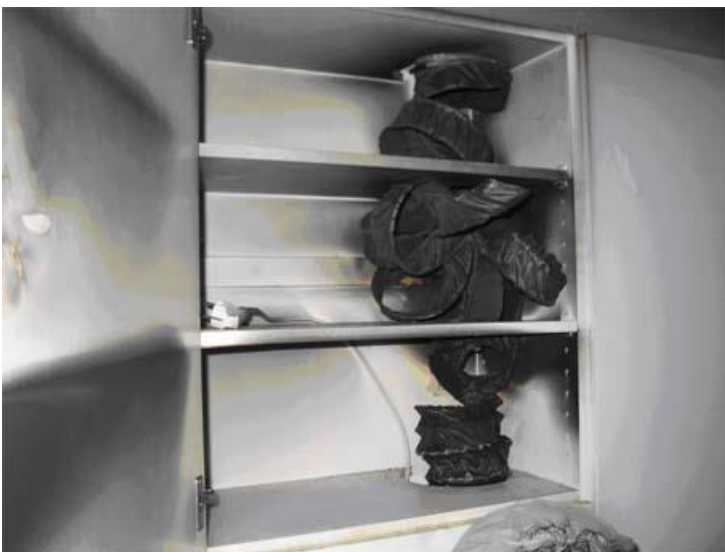
Förbrända rester av ventilationsslang i plast.
