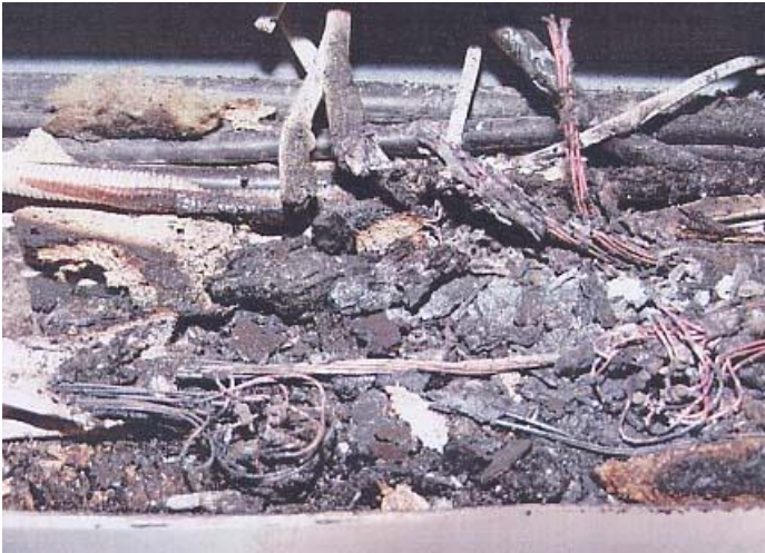
Primärbrandplatsen. I brandhärden finns rester av 3 st elektriska kopplingsdosor.
