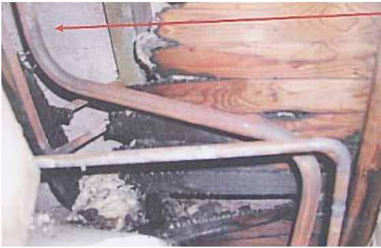
Andra sidan väggen där brännbart antändes.
