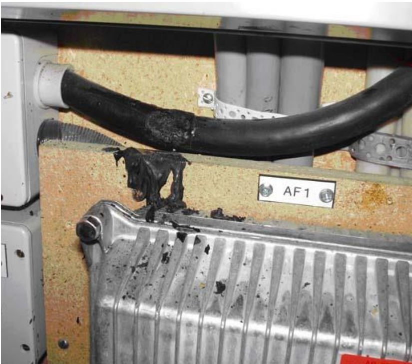
Kabel under har börjat smälta men ej fattat eld.
