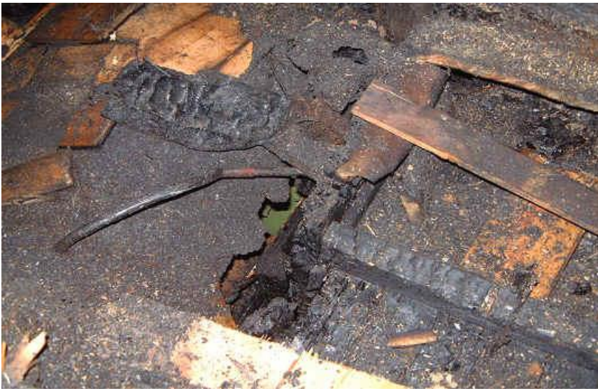
Exempel på elrör och kolskador.
