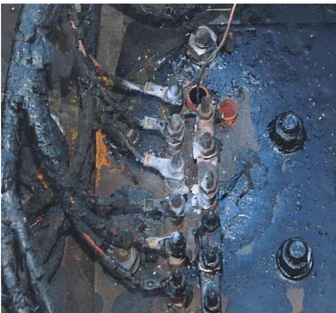
Närbild av kopplingsplint på pannan där jag misstänker glappkontakt.
