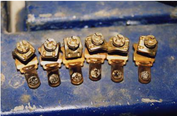
Kontaktbleck i relä, vilket styr värmebatteriets strömförsörjning, har svetskskador vilket kan tyda på att det fastnat i tillslaget läge.
