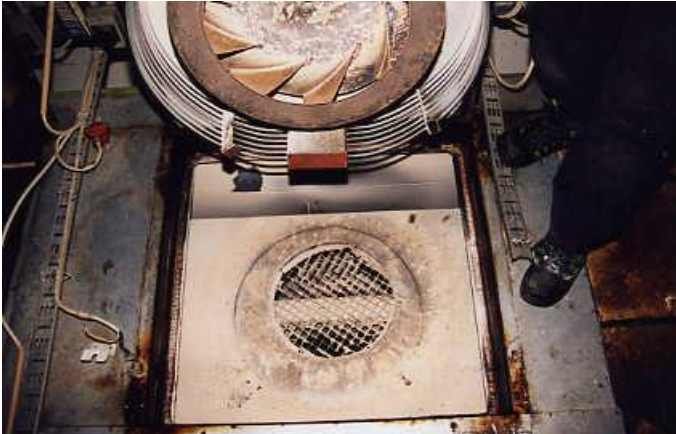
Primärbrandplats. Fläkt och värmeslingor rebrända. Överhettningsskydd sönderbränt.
