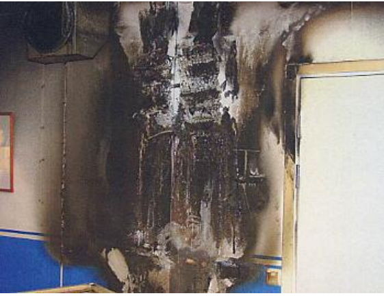
Rester av elcentralen.
