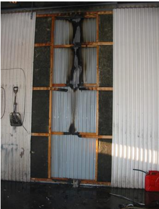
Skador på innerväggen. Plåtbeklädnaden har tagits bort.
