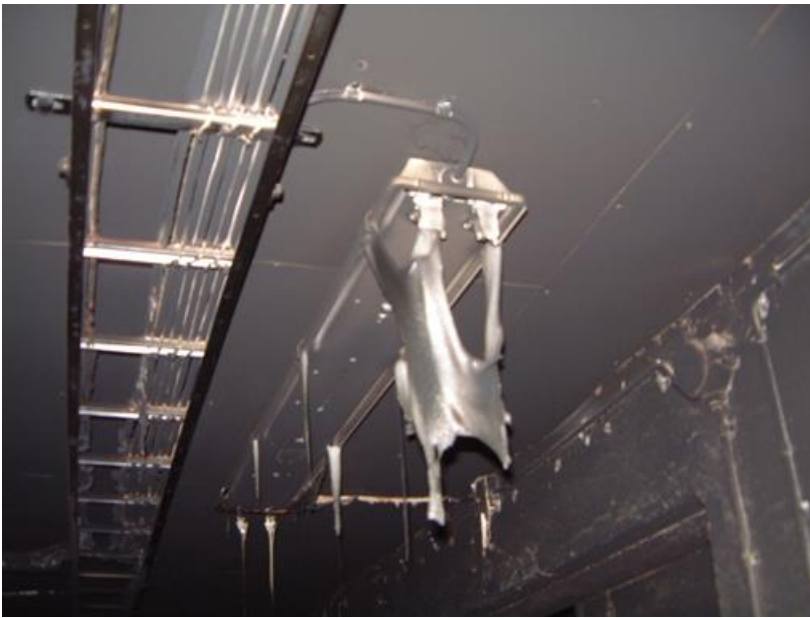
Sot- och smältskador på lysrörsarmatur och kabelstegar.
