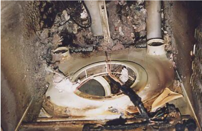
Tumlarens botten efter deformation av trumman. Stora mängder damm finns kvar.
