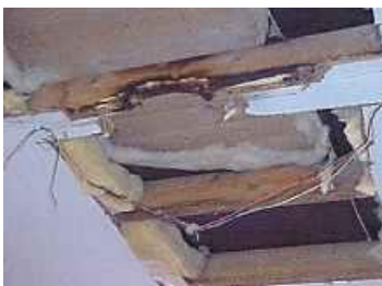
Halvt genomkolad takbjälke.
