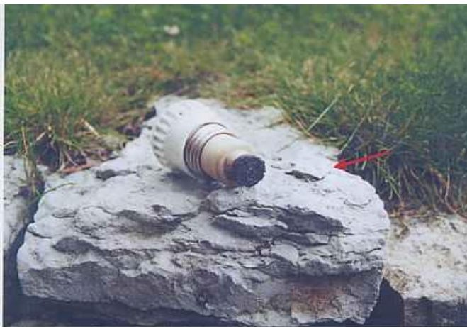
Bild 1: Närbild på säkringen. Spår efter ljusbåge vid pilen.
