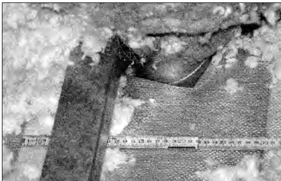
Bild 7 Oisolerat kanalrör genom vindsbjälklag/lägenhetstak. Avståndet till brännbar del (glespanel) är ca 5 cm.
