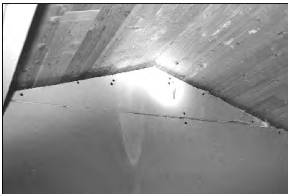
Bild 12 Brandväggens anslutning mot yttertaket, utan gipsskiva mot råspont
