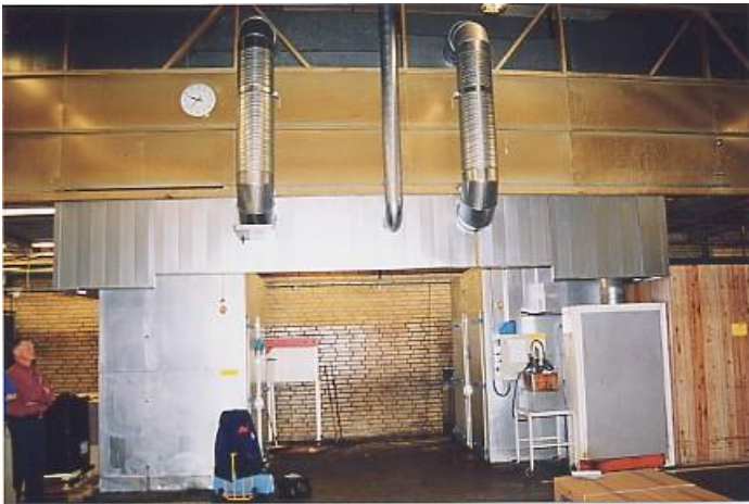
Värmeugnarna med plåtkåpa för uppsamling av vulkgaser.
