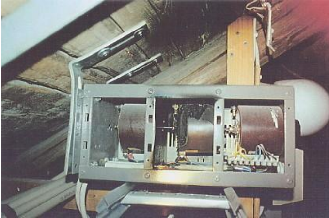
Efter att regulatoren öppnats syns kortslutningen i ena lindningen samt kolningen i taket ovan.
