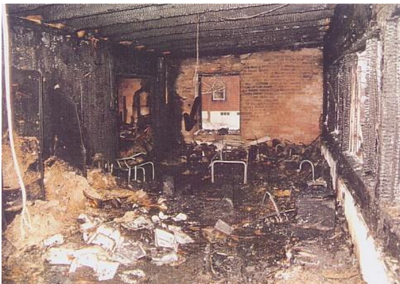
Vardagsrummet som är startrum. Notera väggmaterialet som består av tretex. Fotot taget mot fönster som nämns vid bild 1. Troligt primärbrandområde vid pilen.
