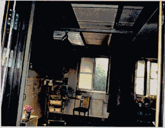
Bild 5. Bilden tagen från dörren i korridor. Sängen stod vid den gula väggen. Röskiktet har legat konstant högt upp tills släckinsats påbörjades.
