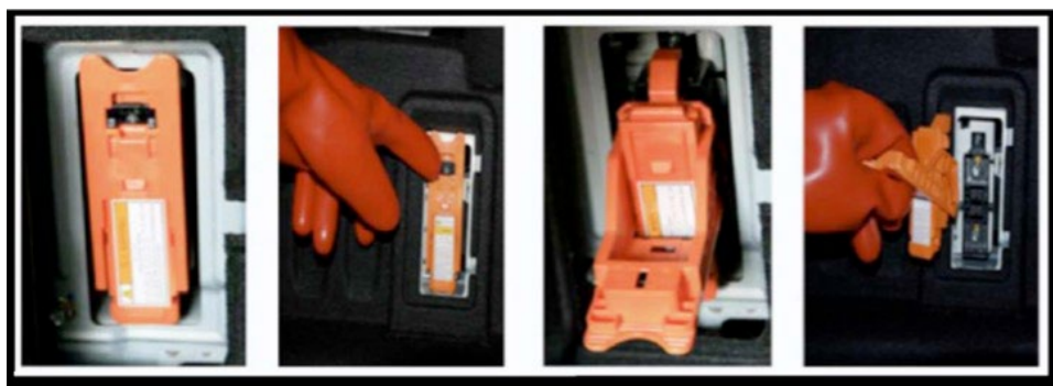
Figur 5. Exempel på strömbrytare för högspänningssystemet.
