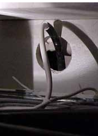
Ett stort hål är borrarat i en brandcellsgräns. Genom denna passerar en smal kabel. Ingen återställning är gjord och risken för rök- och brandspridning är tydlig.
